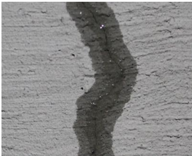
Fot. 1. Izolační nátěr ATLAS WODER SX na povrchu betonu - tlak vody zevnitř. Aktivní netěsnost u trhliny v podkladu.
