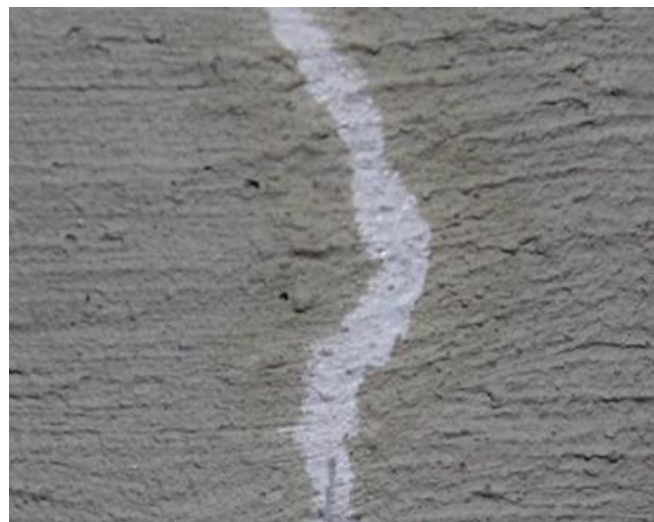
Fot. 4. Uzavření trhliny krystaly soli, bez úniku vody. Účinek po 21 dnech.
