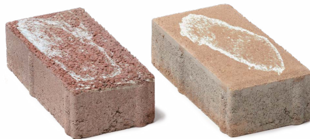
Dlažba s výkvětem
